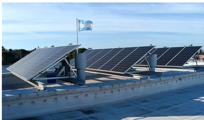
Figura 4: Planta solar fotovoltaica de 7.5 kWp
