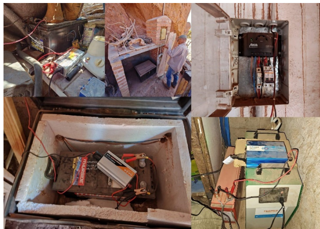
Figura 8: estado de los equipos relevados. Fuente: banco propio de imágenes
