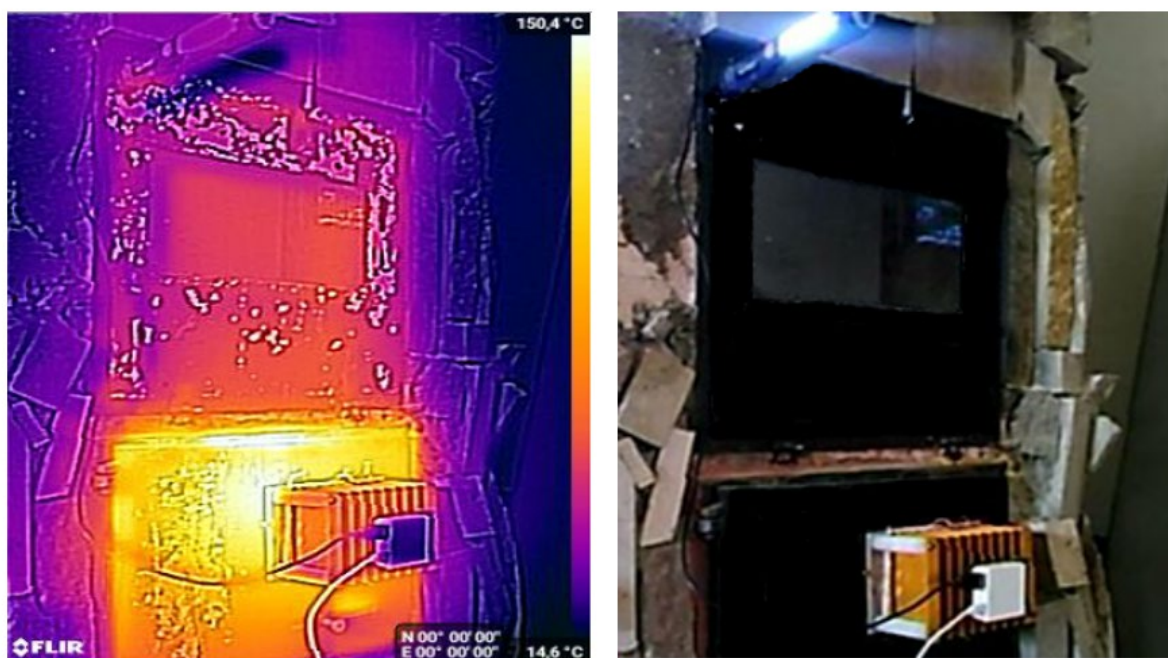
Figura 1. Izq.: imagen termográfica del generador, Der: Imagen del generador operativo.
