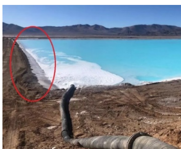
Figura 2 Las membranas geotextiles en pozas solares Gentileza Rebosio A.
