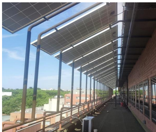
Figura 6: Ampliación de instalación existente: Pérgola FV BIPV. Edificio N° 42 -Tandar-CAC.
